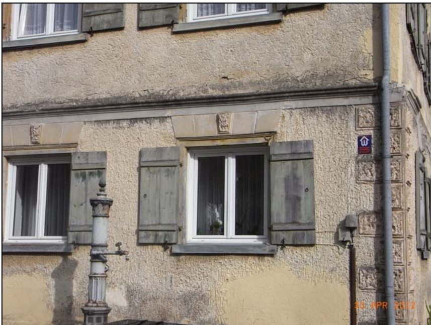
Ökonomiegebäude und Wohnhaus mit sichtbaren Baumängel
